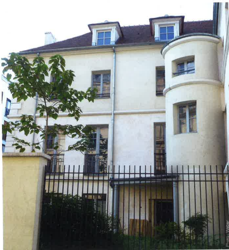
↑ Réhabilitation de l'hôtel Mathagon, à Paris : variété des supports, homogénéité du rendu. MOA RIVP; architecte : Yann Casanova.
