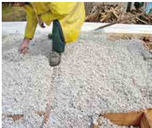
Le mortier est déversé en une fois entre les solives et soigneusement réparti.
